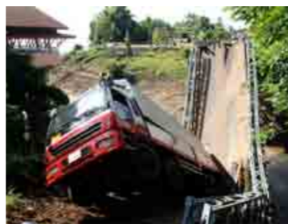
過積載トラックによって路面は削られ、橋梁の崩落などが起こった。写真はチャンバサク県で起こった崩落。
