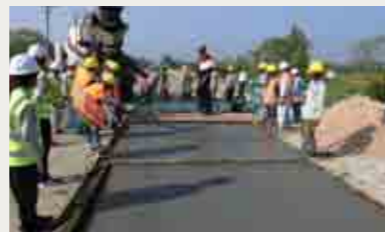
今年2月には、コンクリートの舗装道路が完成した。今はマニュアル作成が佳境に入っている。
